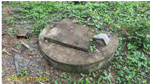
Foto 9 - Caixa de gordura
