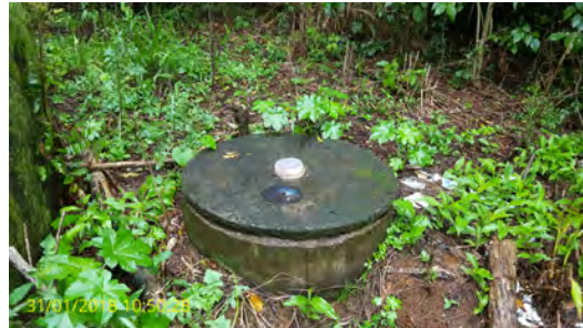
Foto 6 - Caixa de cloração
