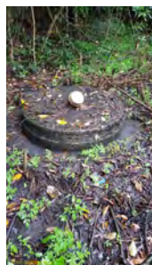
Foto 1 - Caixa de inspeção
