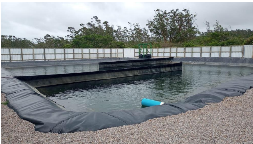
Figura 4 – Estação de Tratamento de Água (ETA) Campo Bom. Fonte: Jaguaruna Saneamento.
