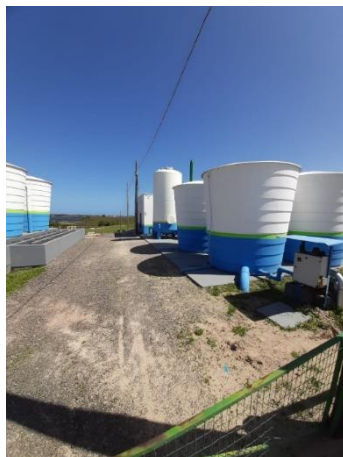
Figura 5 - Estação de Tratamento de Água (ETA) Esplanada.
