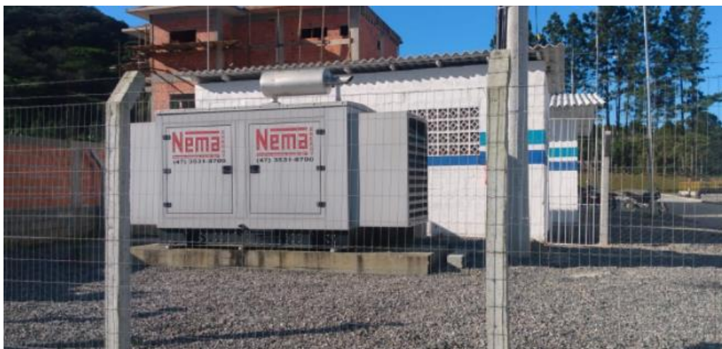
Figura 23: Gerador instalado na ETA Penha.
