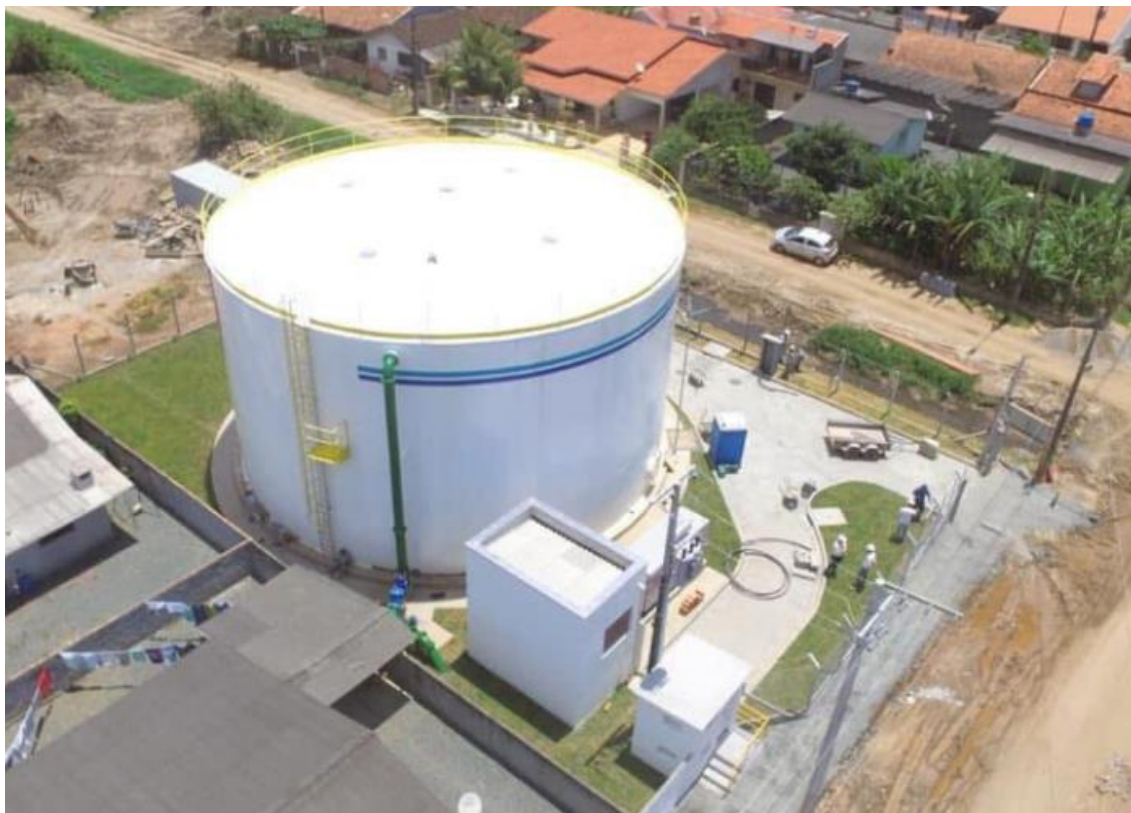
Figura 07: Reservatório R5, 2.000m 3 , no bairro Mariscal.
