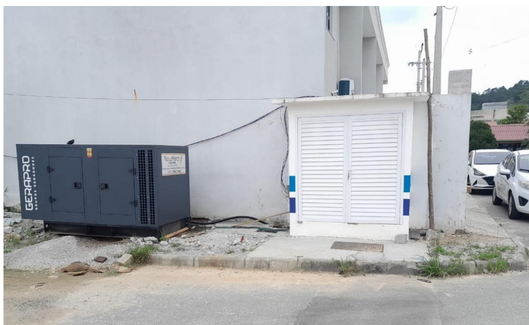
Figura 29: EEE 03 com gerador
