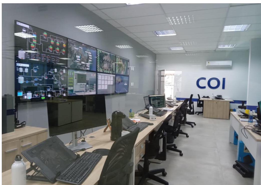
Figura 03: Sala de Centro de Controle Operacional
